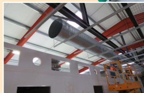
Conducto por encima de la sala de conexión que conecta EnviroTech a la sala de incubación
