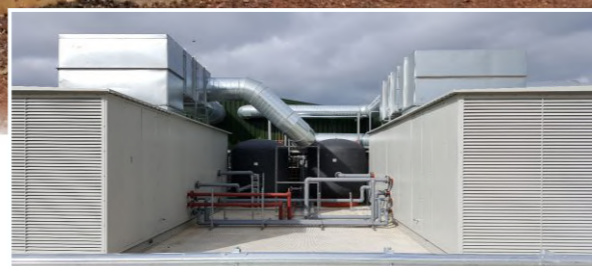
Una instalación en el Reino Unido que incorpora dos sistemas EnviroTech
